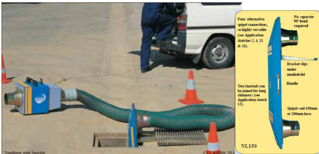
Fig. 24. Accessori per la ventilazione di pozzetti. Si noti la particolare sagoma per consentire l'accesso PRODUTTORE delossan: http://delossan.com/AirCleaners
