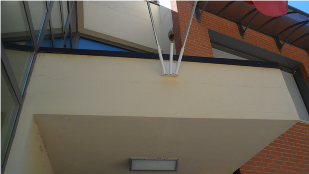
Lesione sull'ingresso principale
