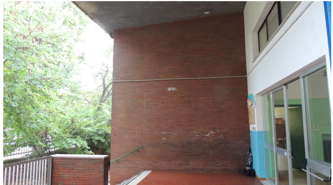
Lesione su parete portante adiacente l'ingresso principale
