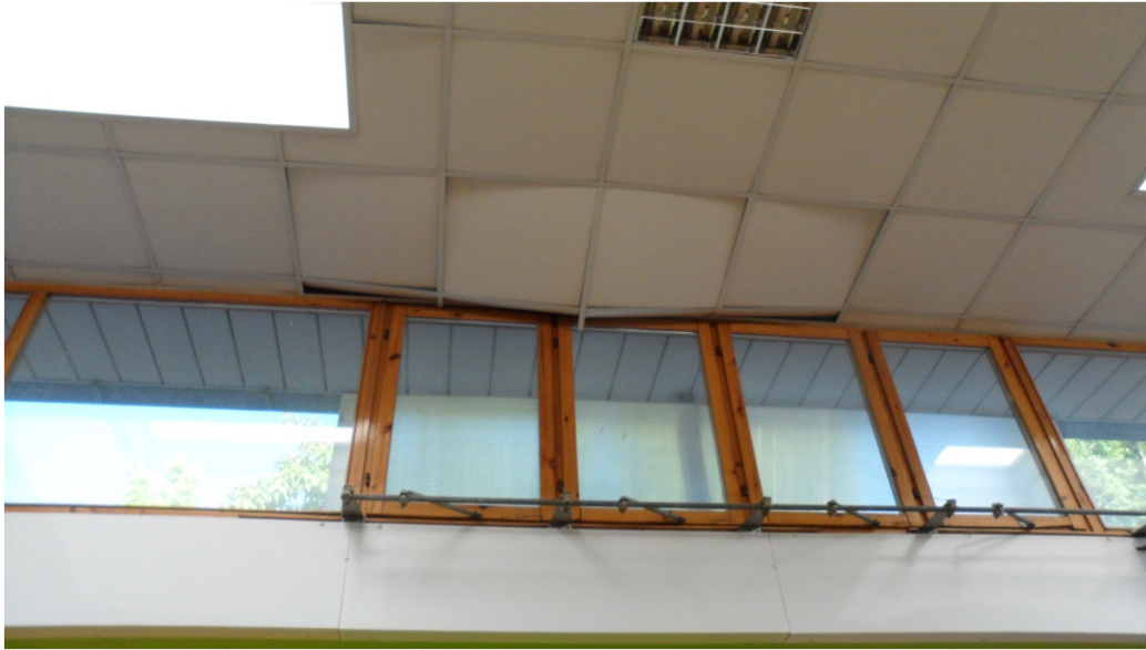
Danno alle controsoffittature
