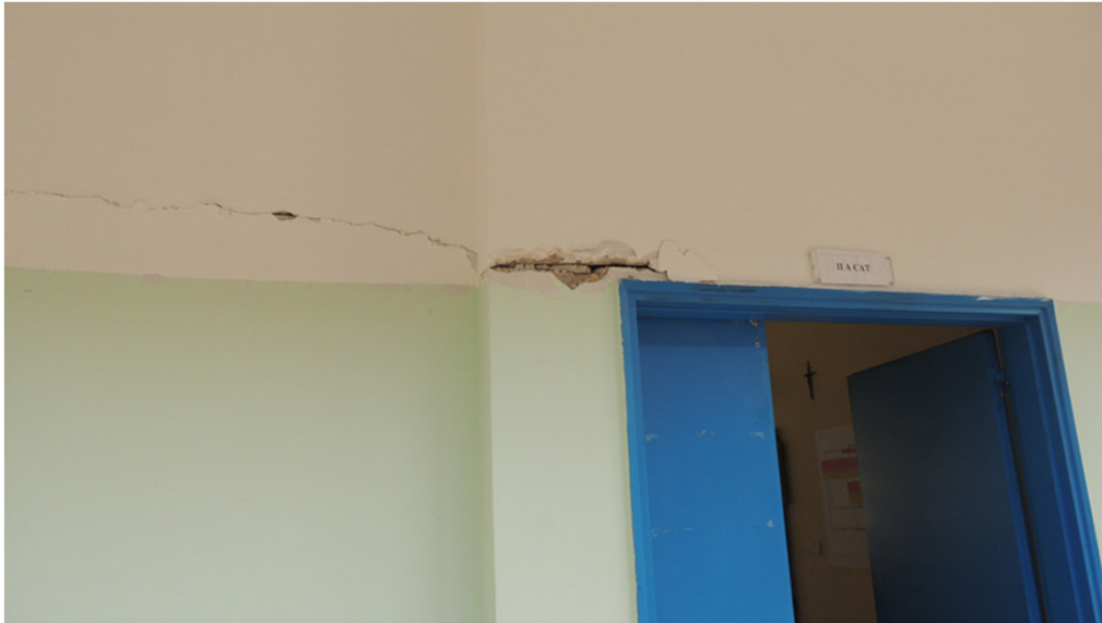
Lesione sull'architrave di una porta di un'aula
